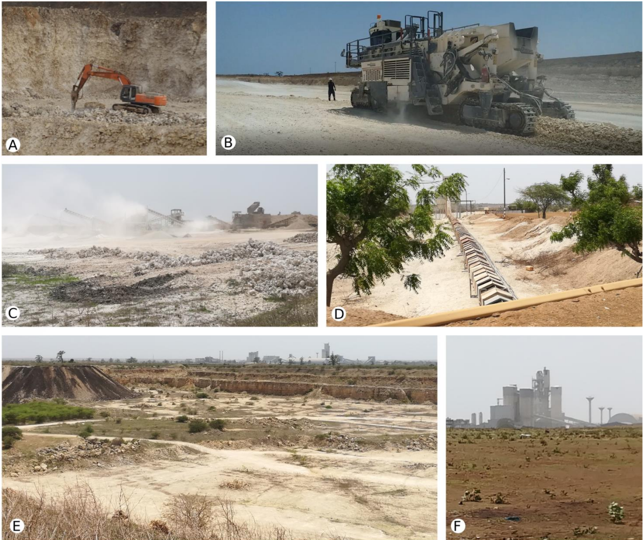
A: brise-roche hydraulique à l'arrêt; B: "surface miner" en action; C: concassage générant de la poussière; D: bande transporteuse vers la cimenterie; E: carrière de calcaire non remise en état; F: cimenterie et avant plan défriché;
