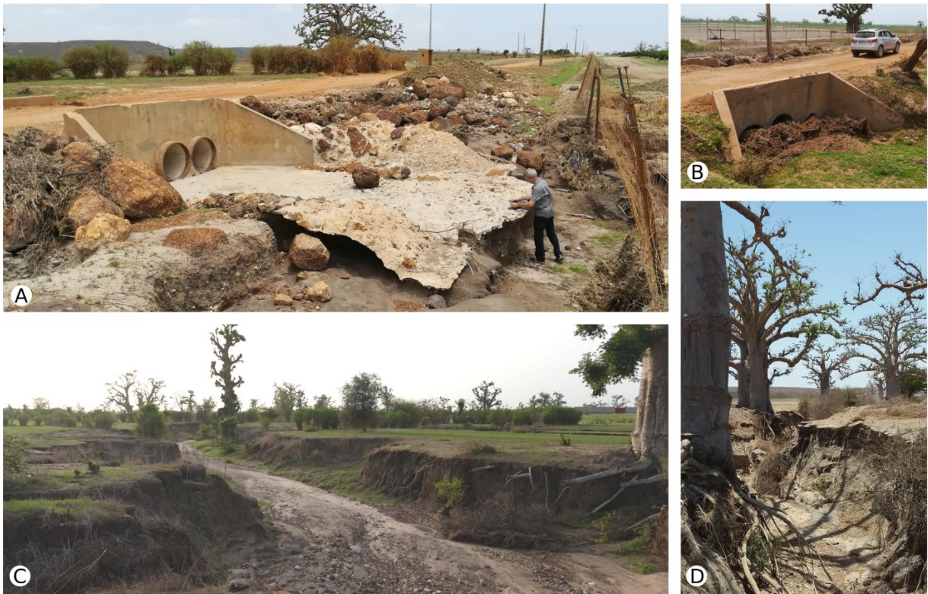
A: érosion intense en aval de buses; B: buse colmatée; C: ruisseau fortement raviné; D: ravine exposant les racines
